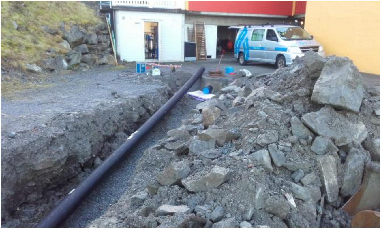
Overløpet går frå kum og på djupt vatn. Pumpestasjonen i bakgrunnen.
