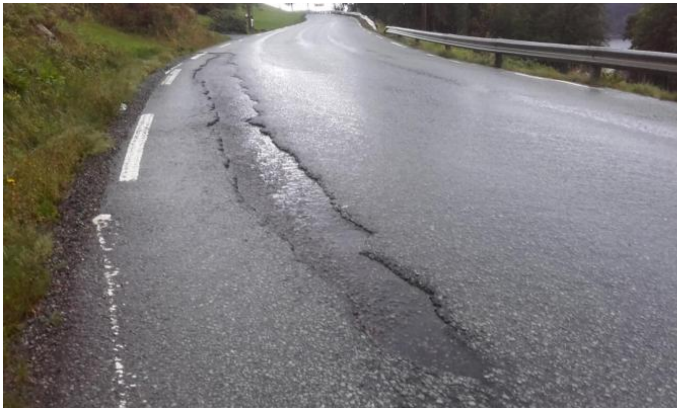
Vegdekket på FV 48 mellom Uskedalen og Herøysundet er i dårleg stand. Vegstrekninga er ikkje på prioritert liste for asfaltering.
