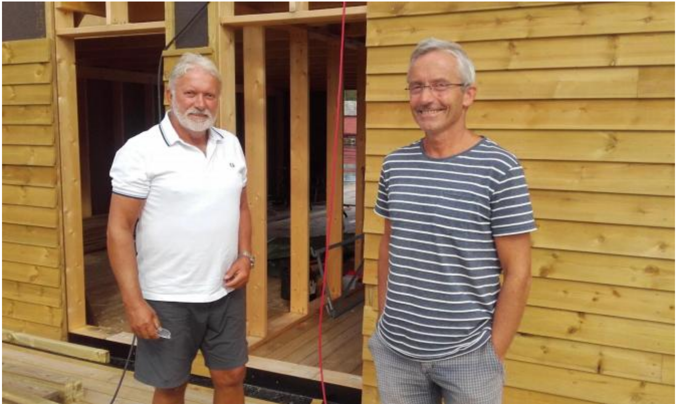
Trygve Harald Hermansen og Dag Hermansen reiser to naust med loft på ein del av grunnflata til Sjøhuset.
