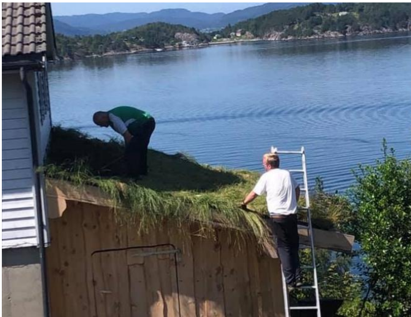
Bjarte Eik på det torvlagde taket på halvtekkja. I stigen: Egil Myhre.
