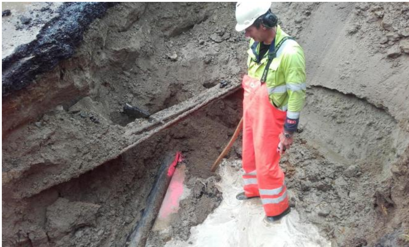
Johannes Kaldestad Feet har lokalisert vassbrotet. I overkant ligg det telekablær.
