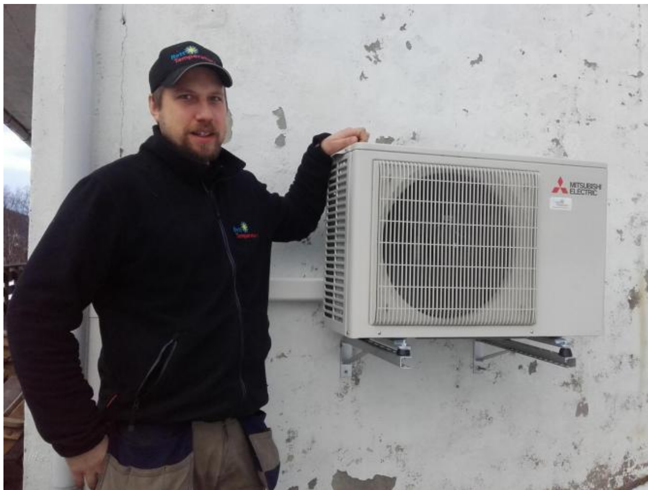
Rett Temperatur AS v/ Roy Helge Døssland har levert og montert varmepumpa på Stemneplassen.
