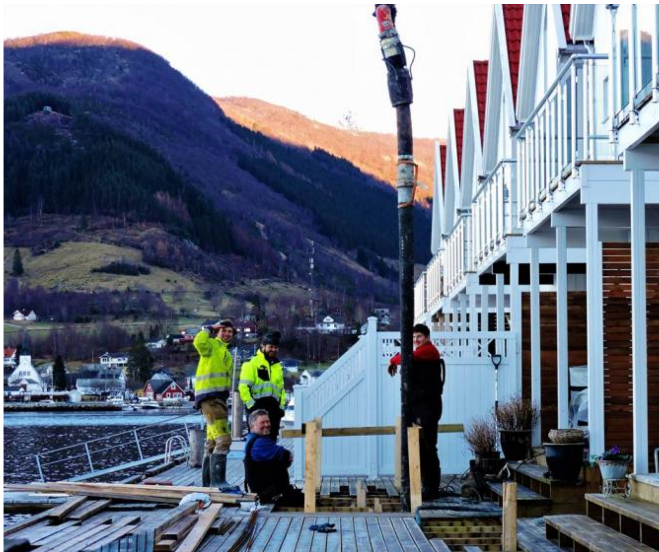
Skjelnes Entreprenør AS vart leigd inn for å utbetra skaden på kaianlegget på Eikelandet Brygge etter nyttårsstormen.
