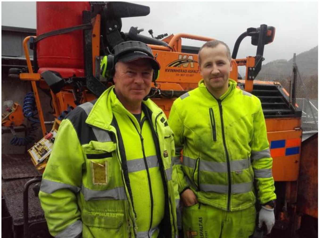
Sindre Stensletten i Kvinnerad Asphalt la ut 80 tonn asfalt i tunet kring Sekundærstasjonen.
