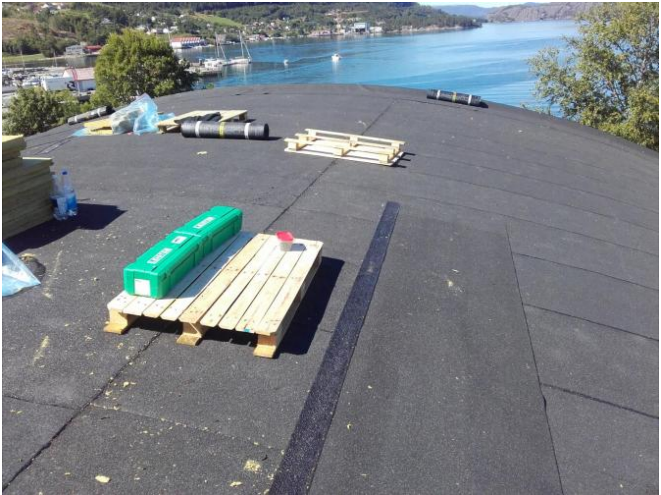
Det nye taket er på plass og arbeidet vert ferdigstilt i denne veka.
