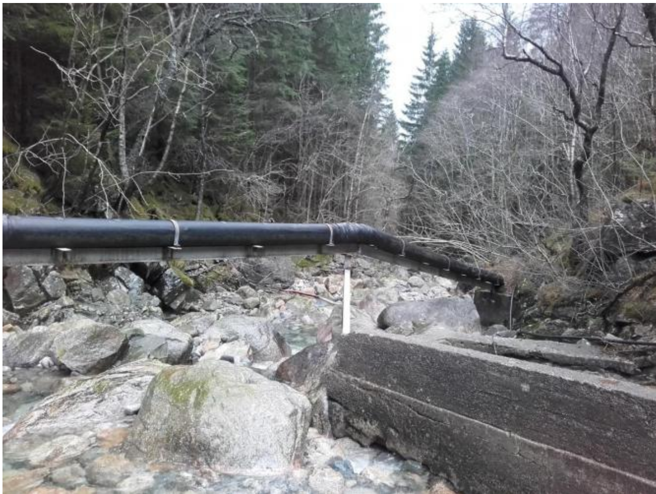
Uskedal Vassverk står føre store investeringar i åra framover med mellom anna fornying av ledningsnett og nytt inntak i Eikedalen.
