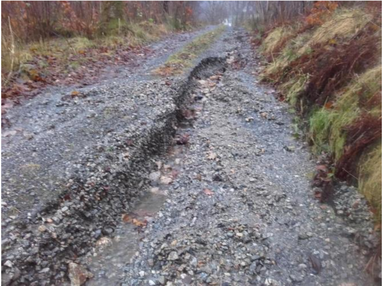
Det er gjort skade på nokre grus- og sidevegar.
