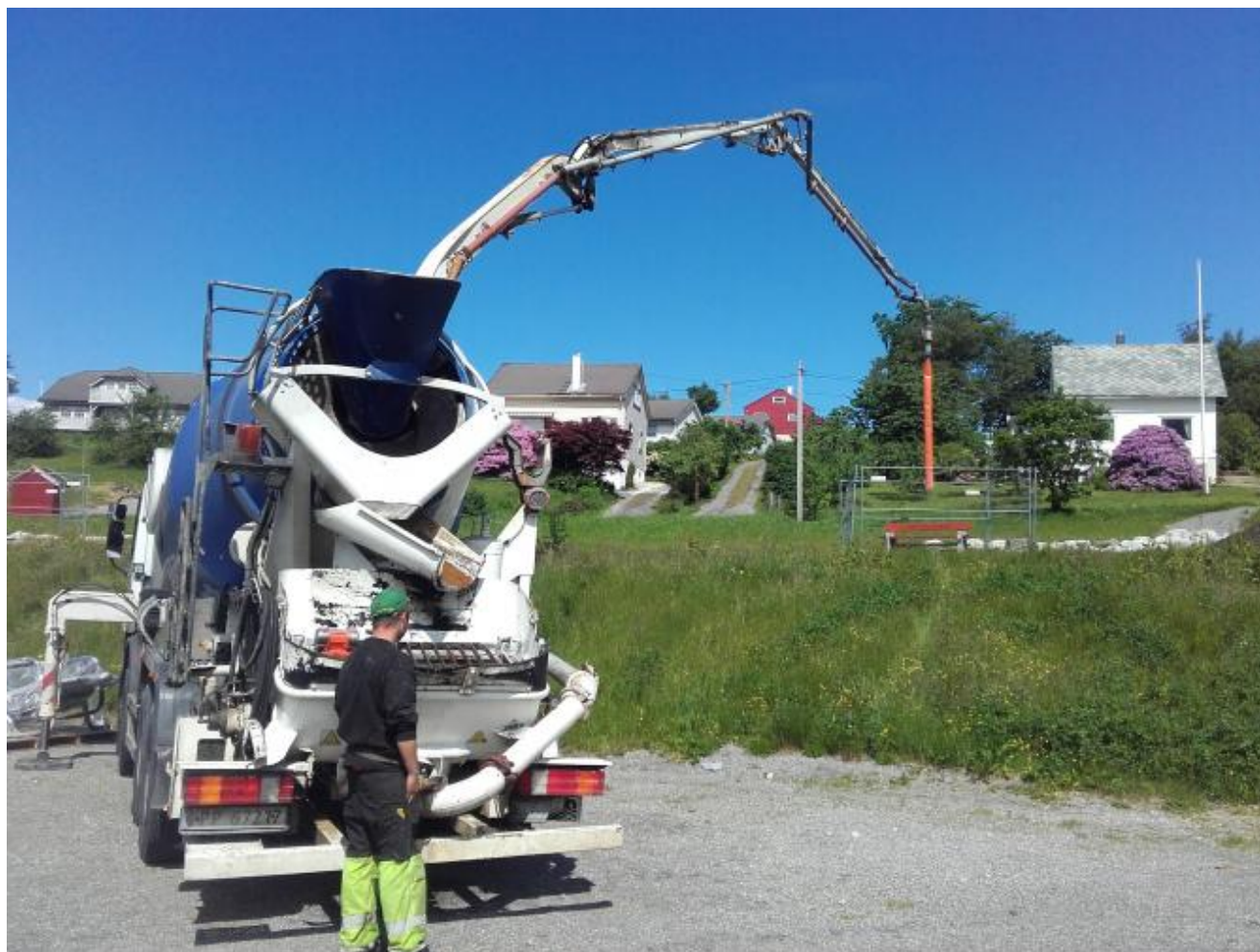
Betongvarer i Dimmelsvik med sjåfør Gaute Moberg legg ut betongen i fundamenta til treningsapparata.
