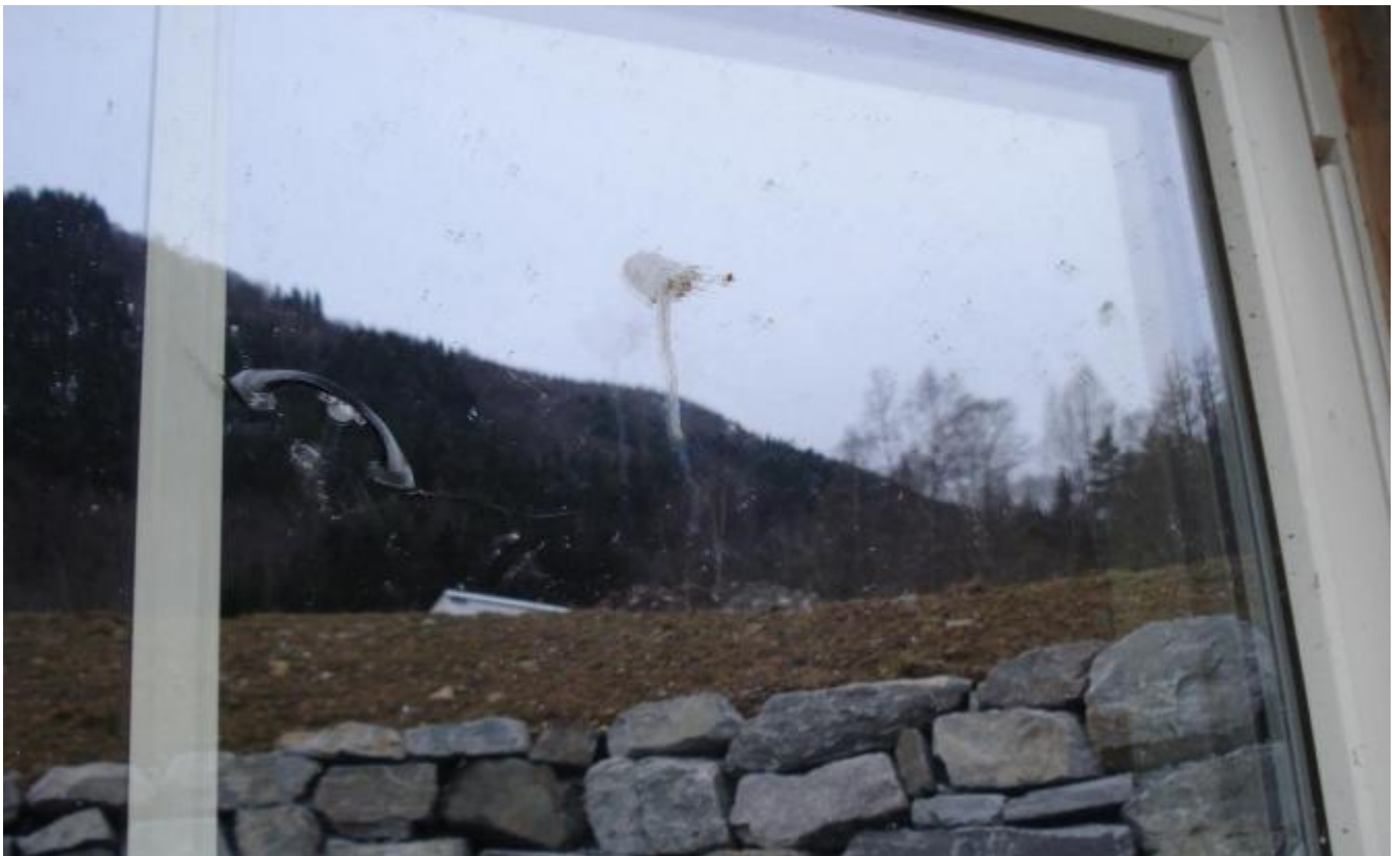
Sprekk i vindauge vart og oppdaga.
