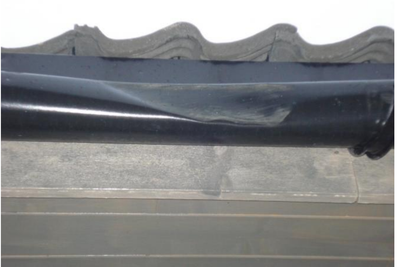
Solide krefter! Kraftig bulk i takrenna.
