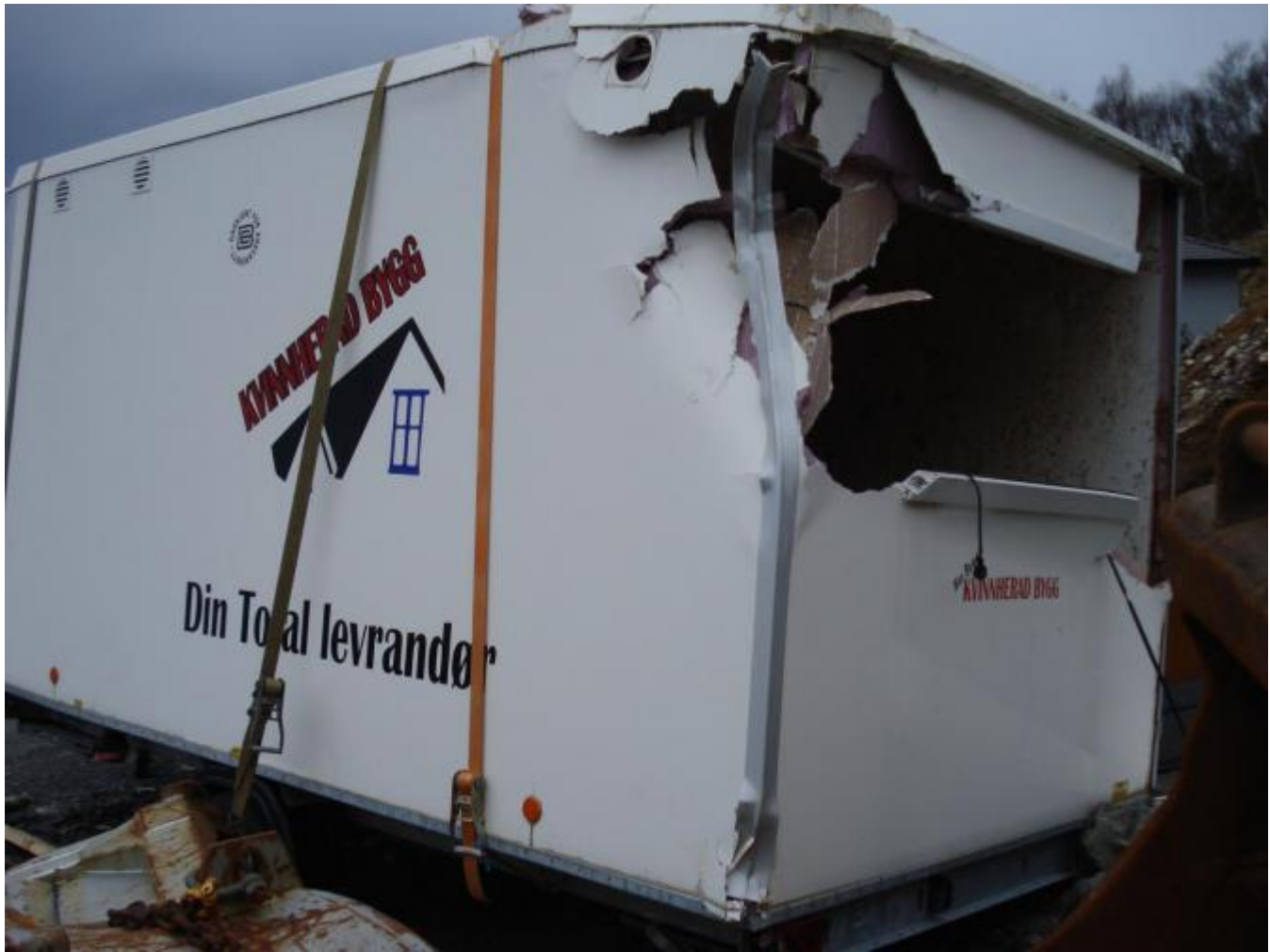
Denne bygningsbrakkavart teken av stormen.
