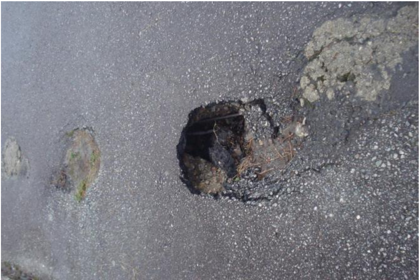
Det hadde grave ein del under asfalten langs kanten
