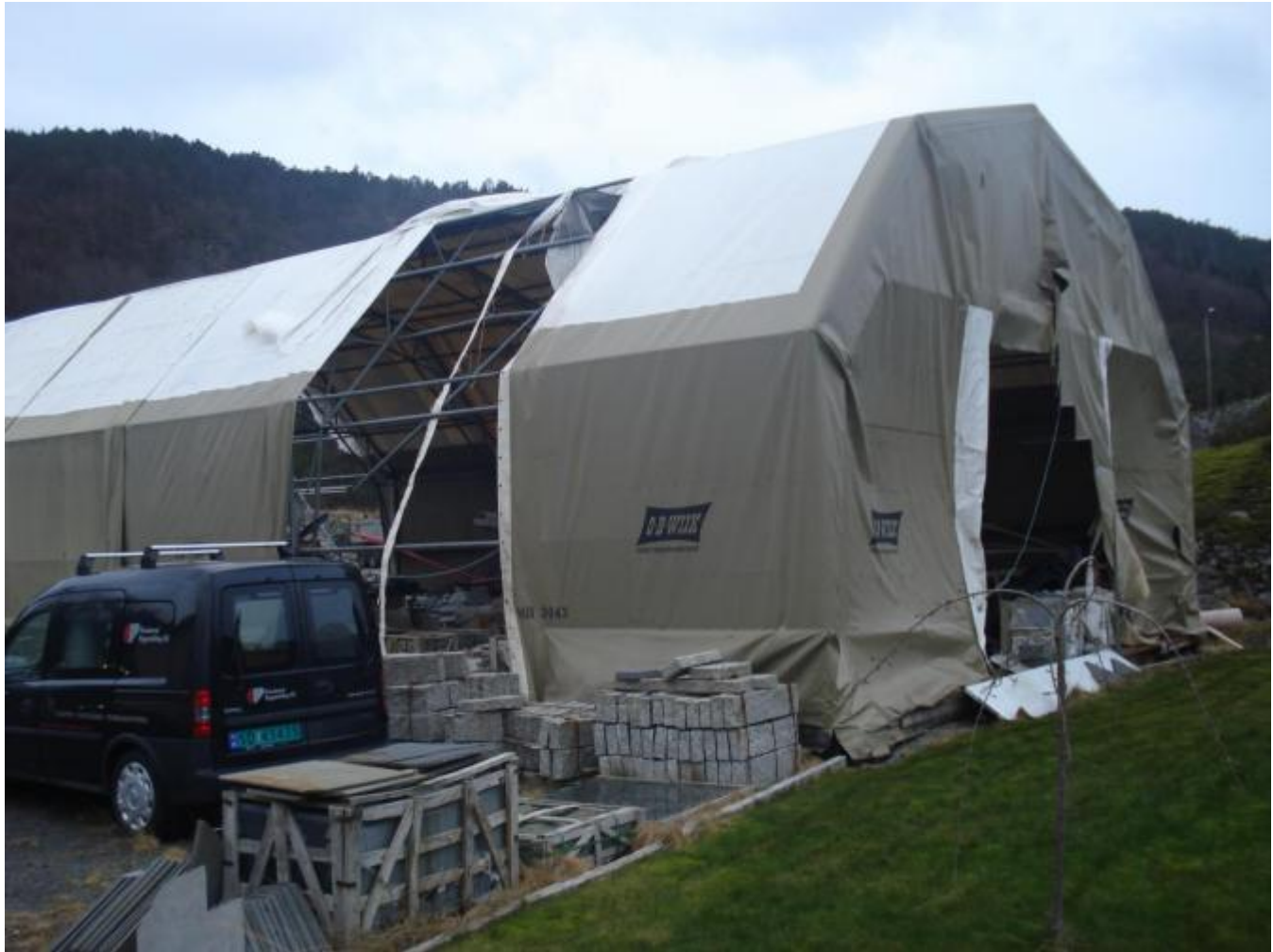
Skade på hallen til Kvinherad Byggutvikling på Børnes
