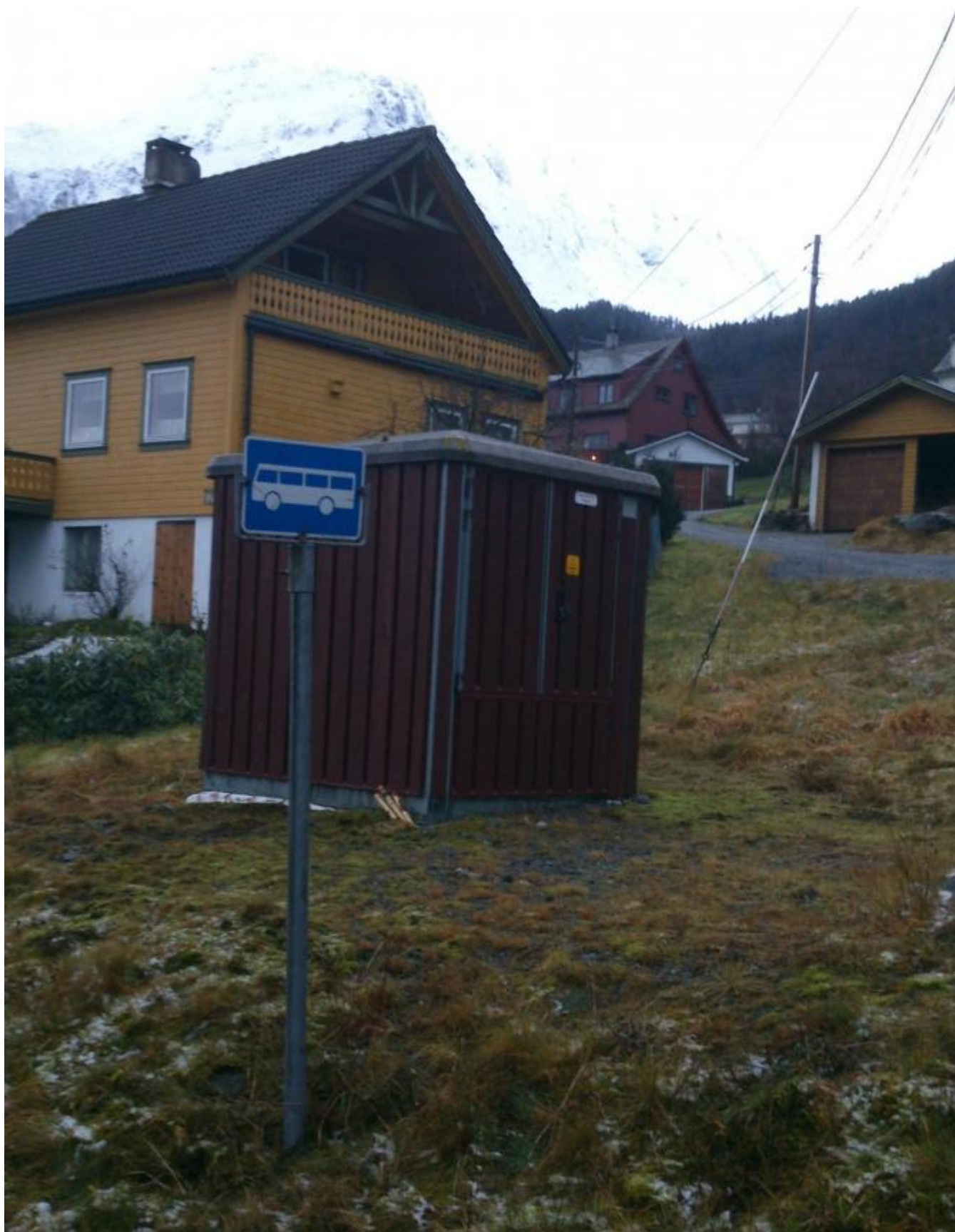
Det var denne transformatoren som måtte skiftast.
