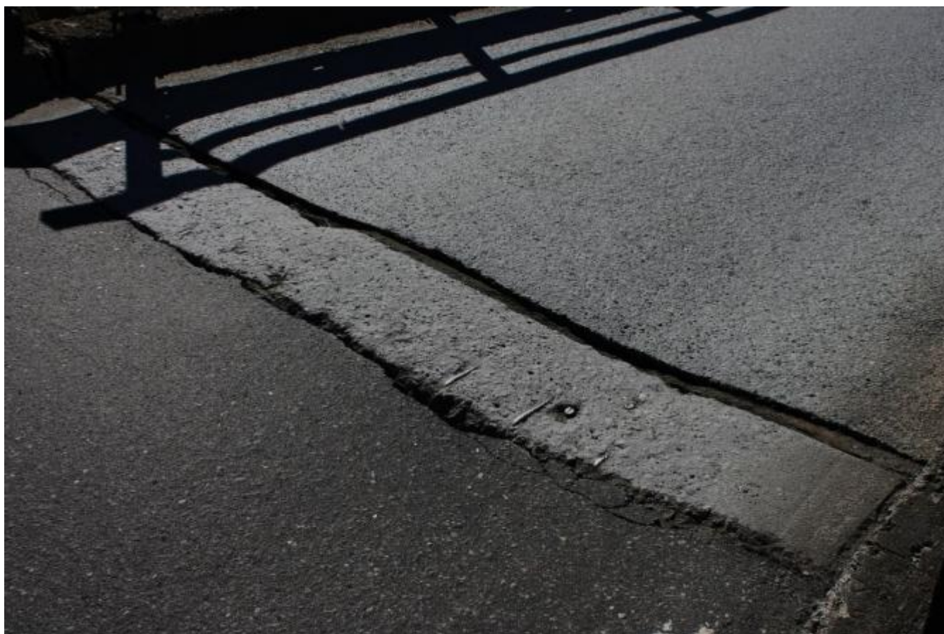
Dette er ein av dei 3 plassane der dekket er sterkt skada
