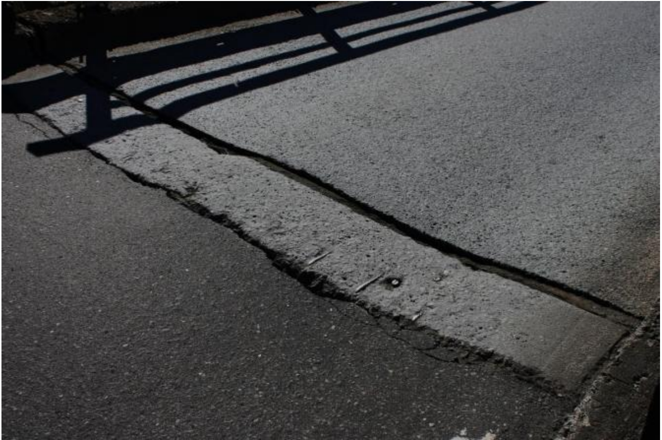
Dekket i brua frå 1936 treng sårt opprusting
