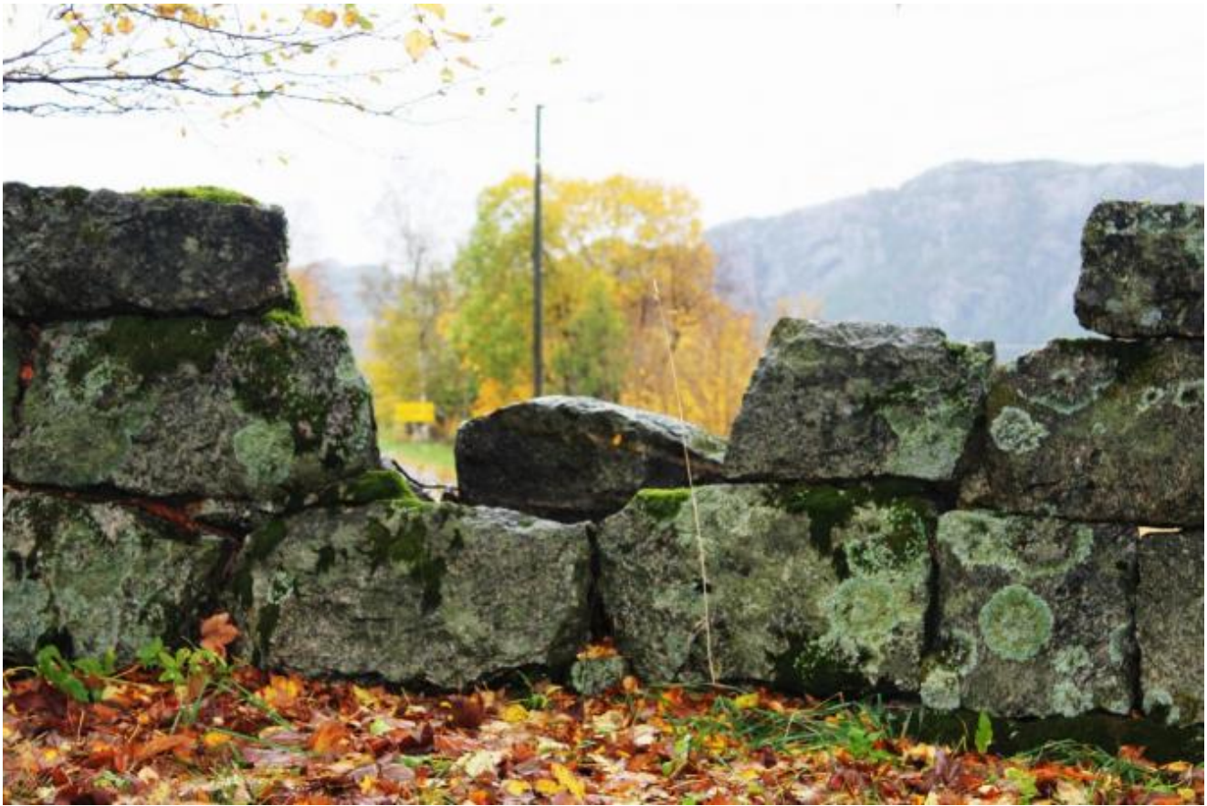
Muren har rasa ut tre stader
