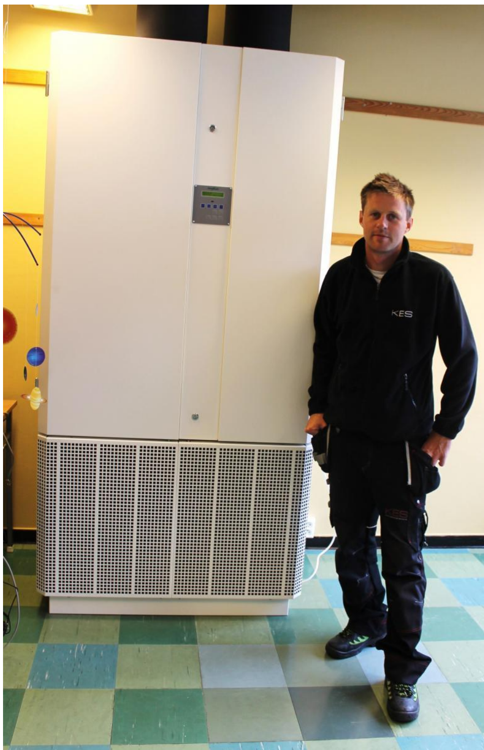
Trond Johansen med 'hjernen' i ventilasjonsanegget
