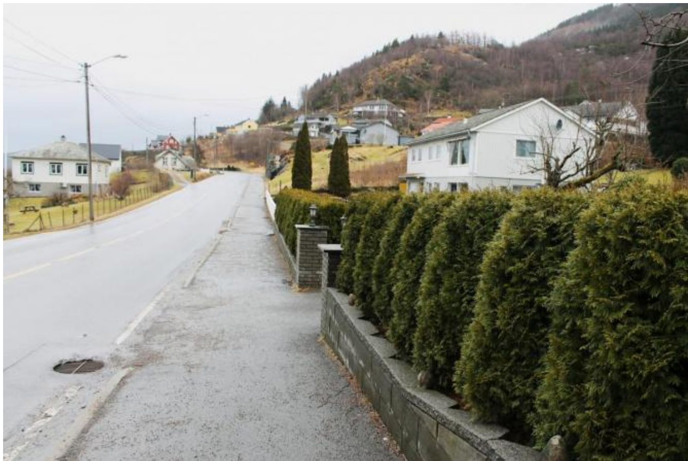
Fylkesvegen har setnings-skadar der spillvatn og overvatnsleidningar kryssar
