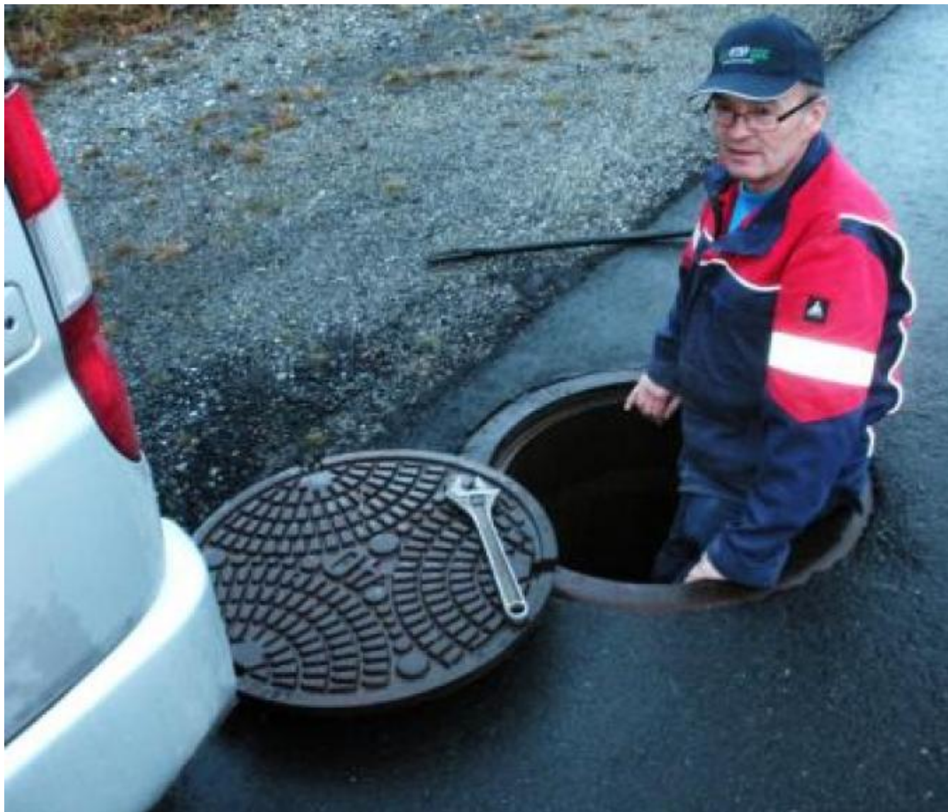
Røyreggjær Knut Stensletten på sporet etter ein lekkasje på Korsnes ved eit tidlegare høve (Foto: Ola Matti Mathisen)
