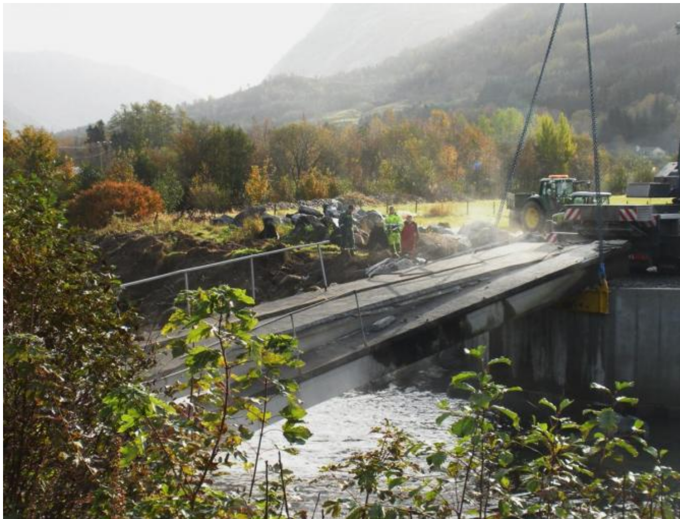
Dette er den mislukka løfteoperasjonen i oktober 2009. Brua fall ned og vart delt i 3. (Foto: Ola Matti Mathisen)
