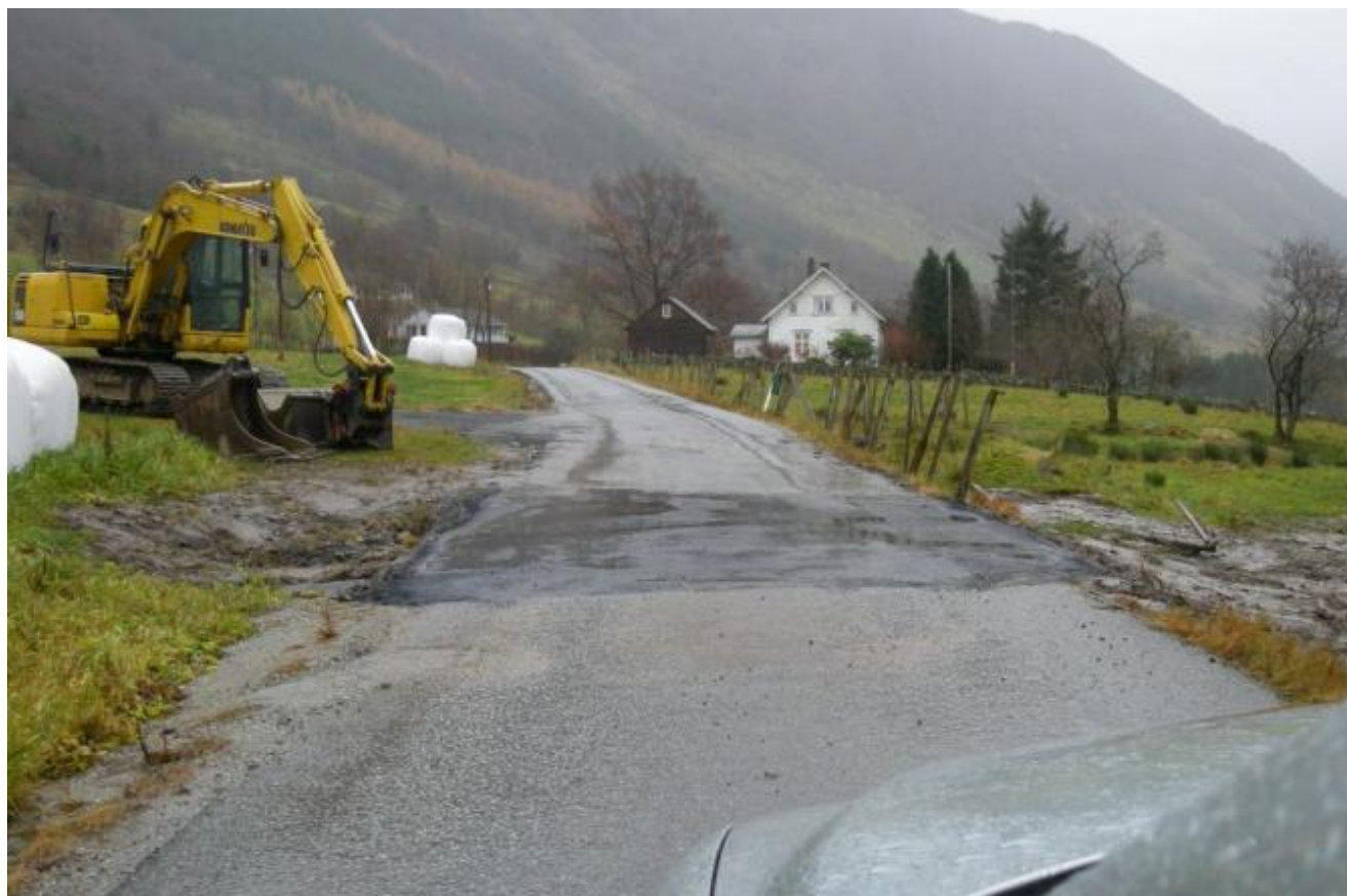
Skaden ved Kjerland vart raskt utbetra. (Foto: Ola Matti Mathisen)
