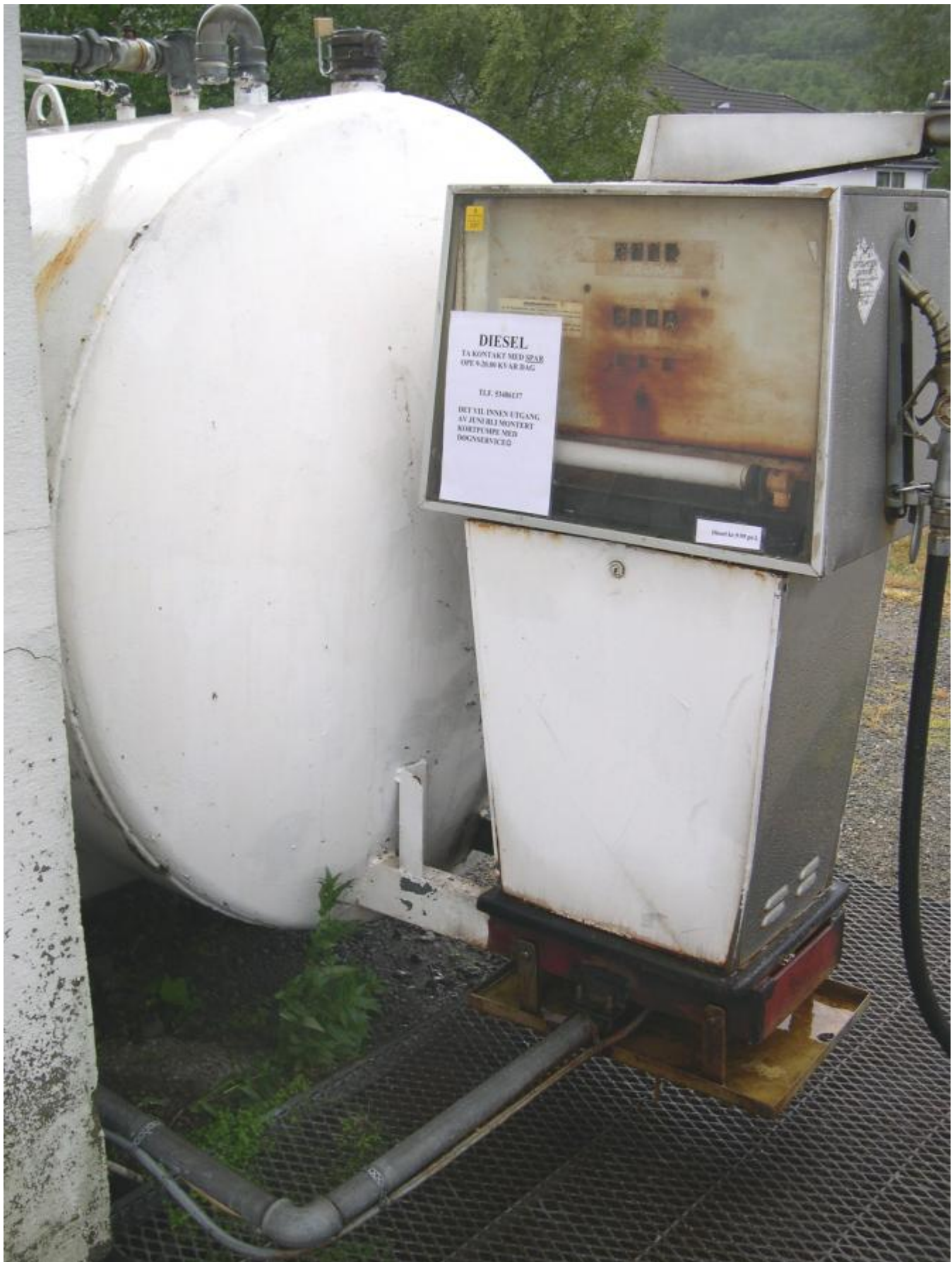
Kortpumpa vil avløysa denne pumpa på Sandakaien om eitpar veker. (Foto: Ola Matti Mathisen)
