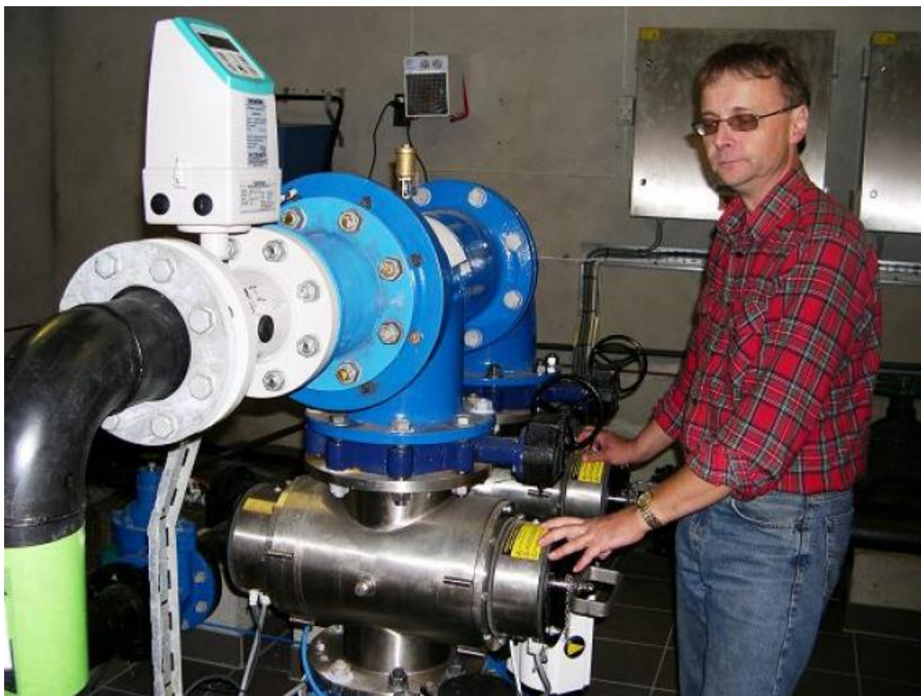
Vassverket skal byggja lager. Her er formann Hans Reidar Kjærland ved eit sentralt punkt i vassforsyninga. (Foto: Ola Matti Mathisen)
