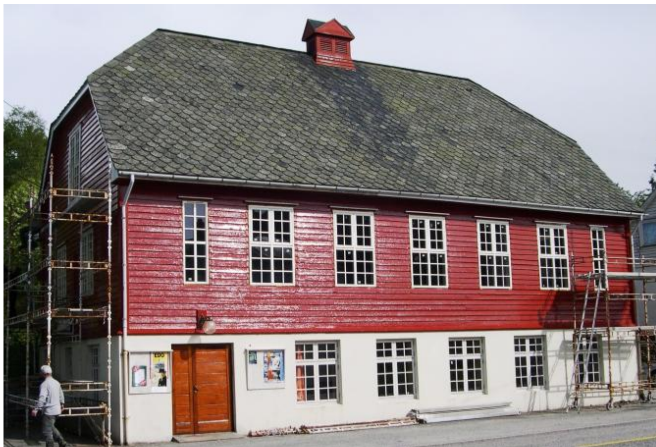
Helgheim er no restaurert grundig – og det har kosta ein betydeleg sum trass i ein stor og imponerande dugnadsinnsats. Her er målinga i gang i fjor sommar. (Foto: Ola Matti Mathisen)
