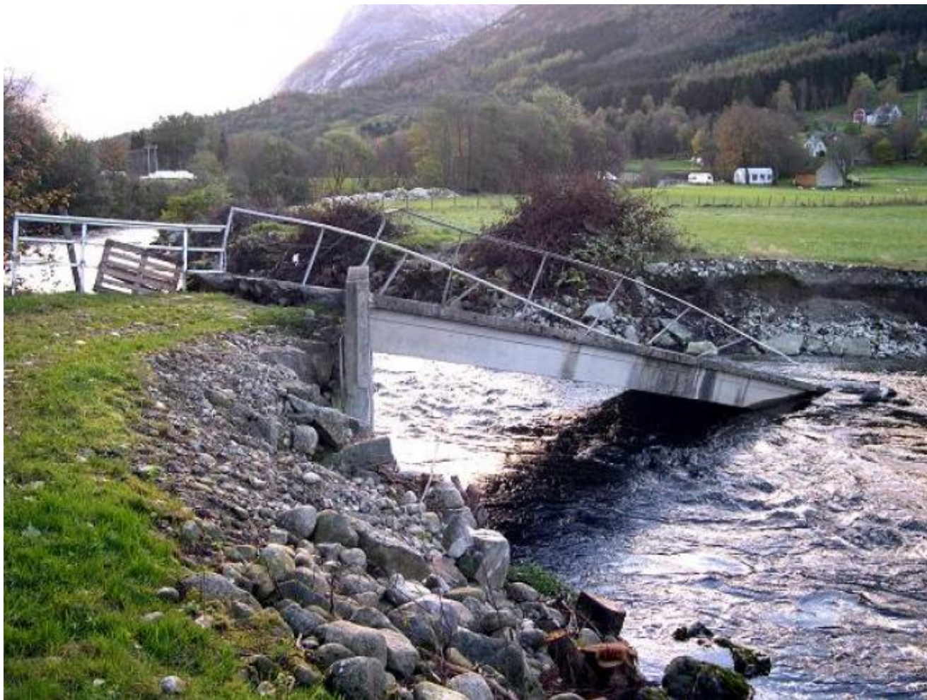
Brua ved Dønhaughølen har lege slik sidan flommen hausten 2005. (Foto: Ola Matti Mathisen)
