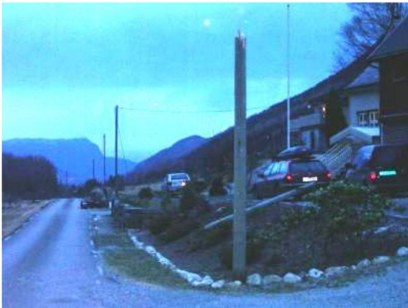
Ein av stolpane på lågspenlinja forbi Musland nedre vart broten tvers av i stormen. (Foto: Ola Matti Mathisen)
