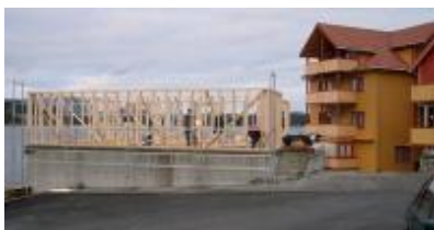
Arbeidet med eit nytt bygg i Beinavikjo går raskt framover. (Foto: Ola Matti Mathisen)
