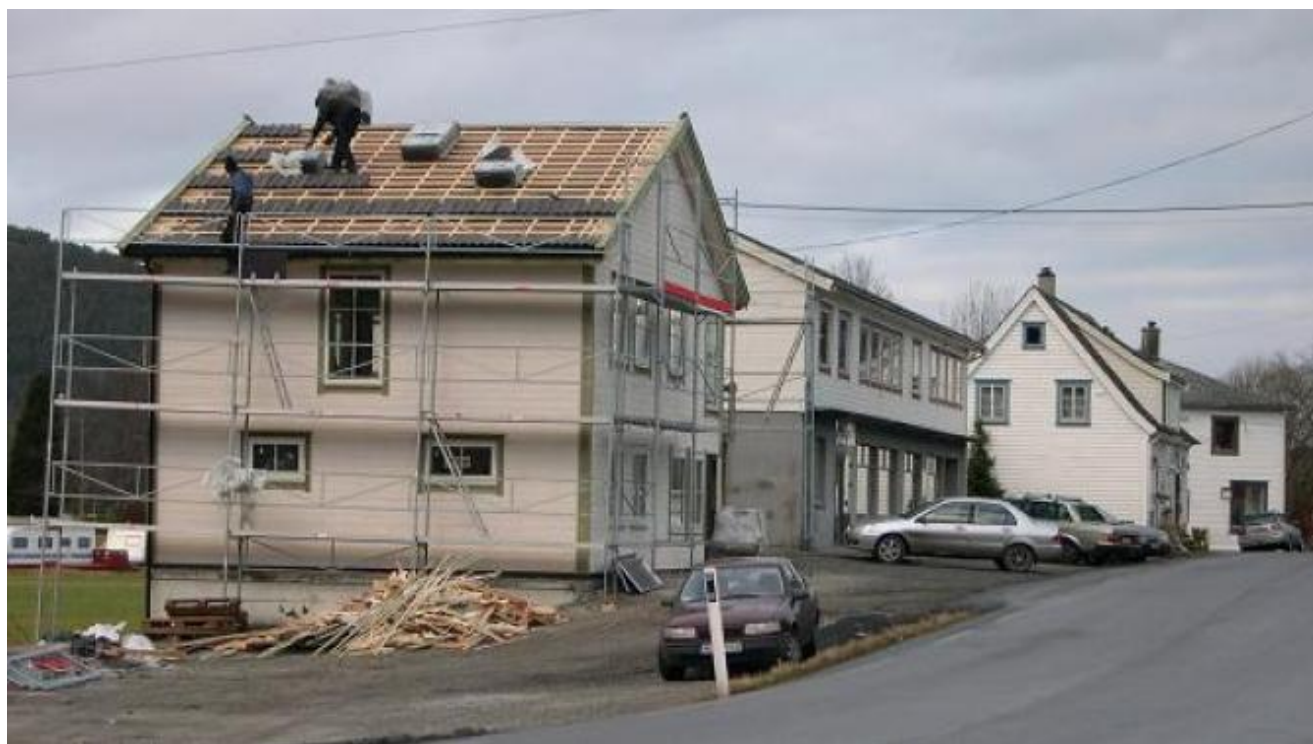
Det nye huset like ved elva er reist svært raskt og torsdag var leggjinga av takstein i gong.. (Foto: Ola Matti Mathisen)
