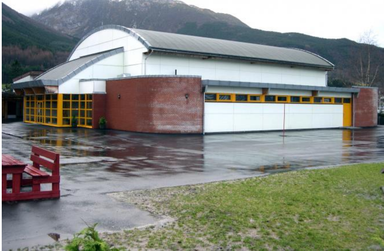
Det brennbare materialet i inngangspartiet var eit av avvika som vart trukke fram under branntilsynet for Aktivitetshuset. (Foto: Ola Matti Mathisen)
