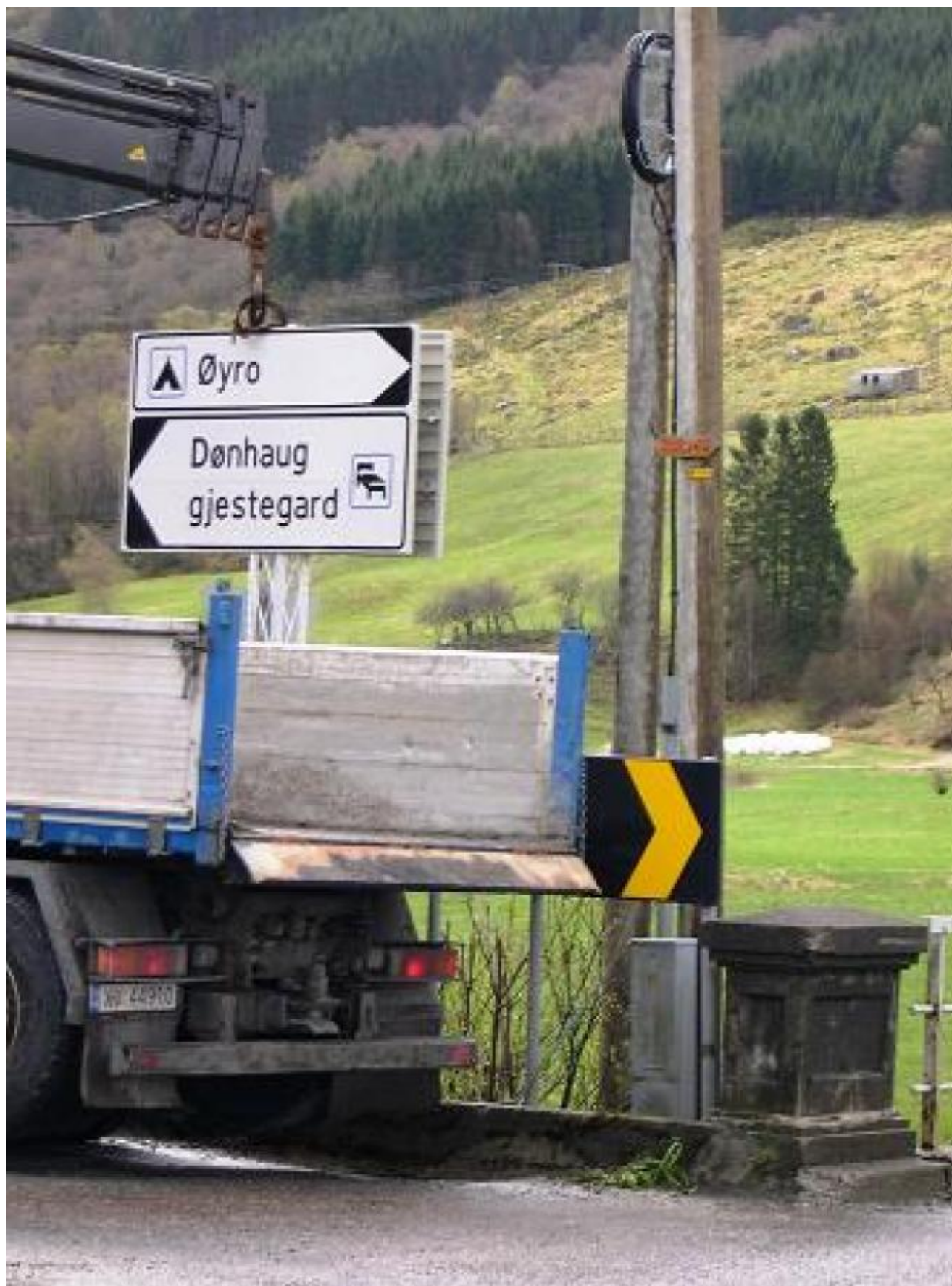
Skilta mot Øyro og Dønhaug kom på plass ved brua tirsdag føremiddag. (Foto: Ola Matti Mathisen)
