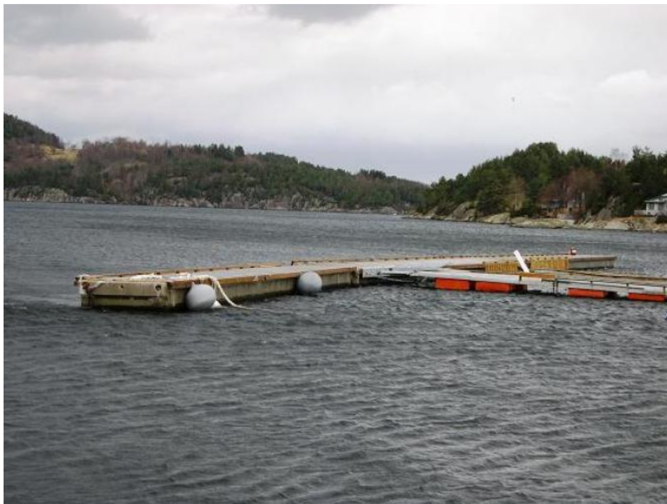
Betong-elementa lengst ute må erstattast med kraftigare saker, men forsikringsselskapet vil førebels betala erstatning for berre to av dei. (Foto:Ola Matti Mathisen)
