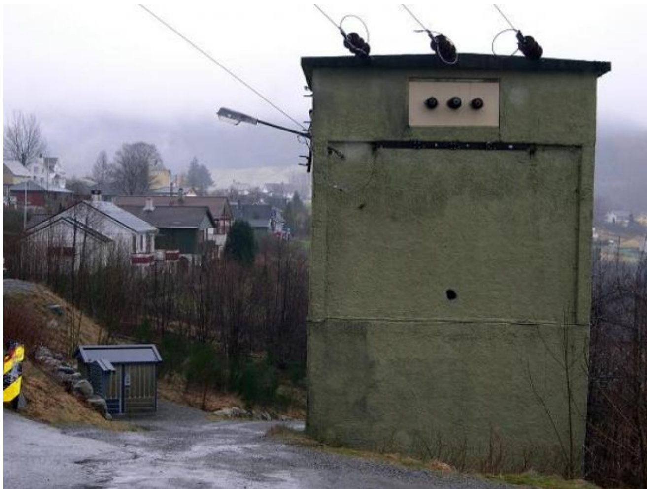
Transformatorkiosken i Halsane blir nok ståande ei stund til....(Foto: Ola Matti Mathisen)
