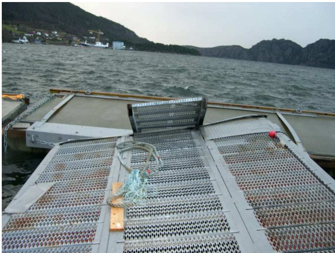
Betong-elementa som var skamfert av stormen skal erstattast med breiare og djupare element. (Foto: Ola Matti Mathisen)
