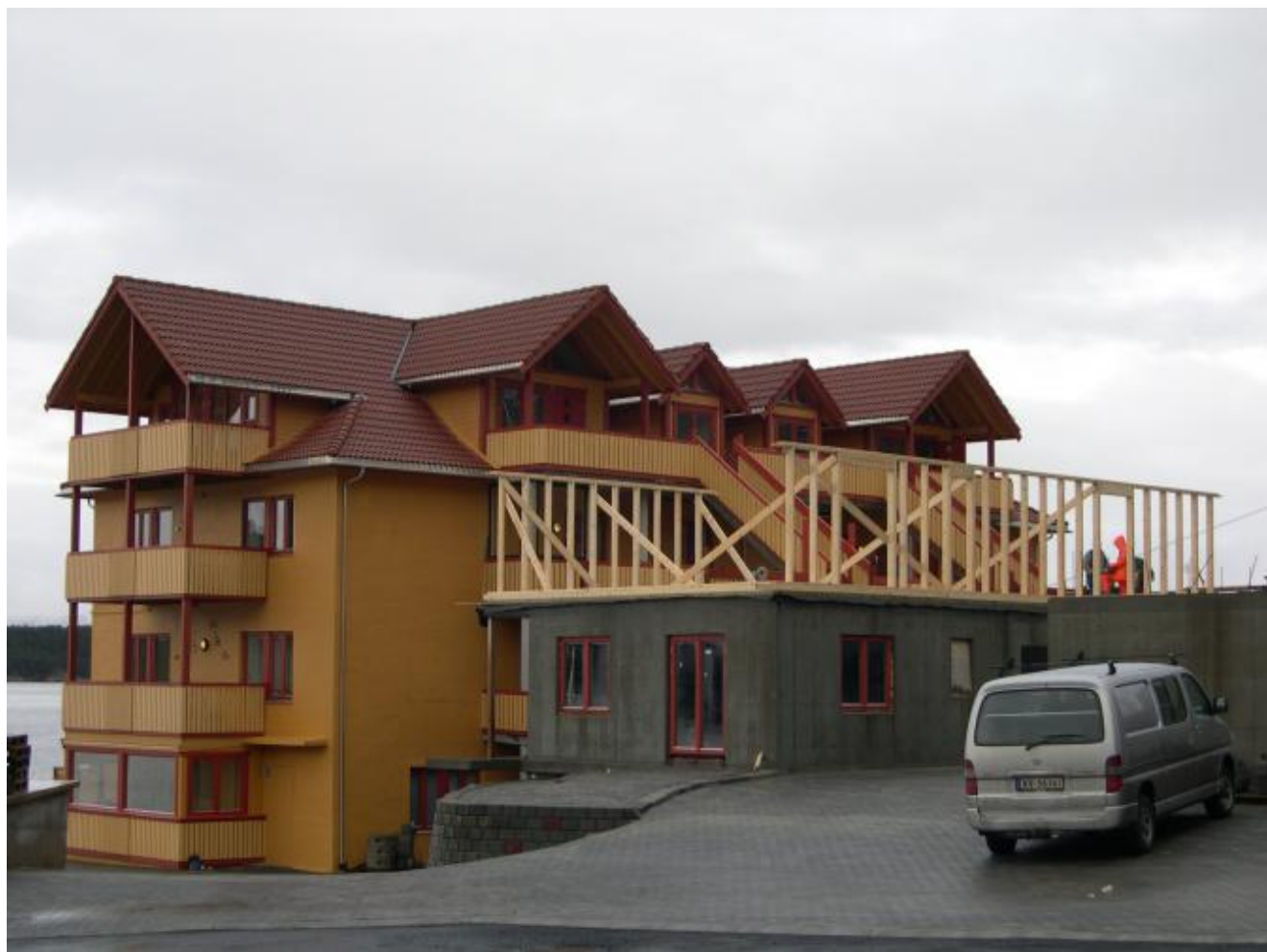
Arbeidet med byggjesteg to er no i gang i Beinavikjo. (Foto: Ola Matti Mathisen).
