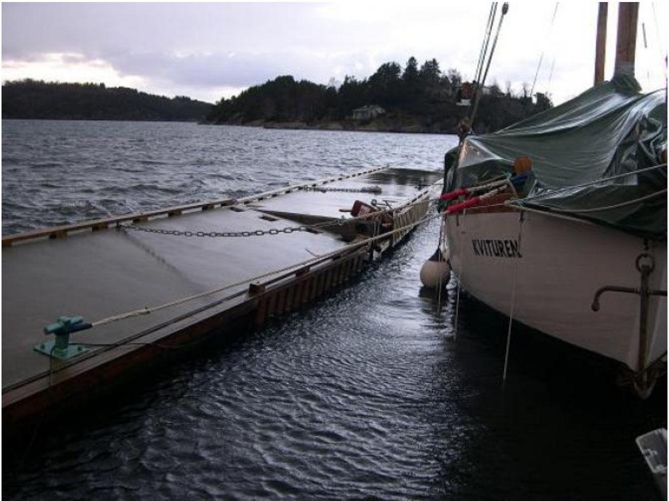
To av dei tre betong-elementa som låg ytterst mot fjorden må truleg vrakast. Dette biletet vart teke om morgonen etter storstormen. (Foto: Ola Matti Mathisen).
