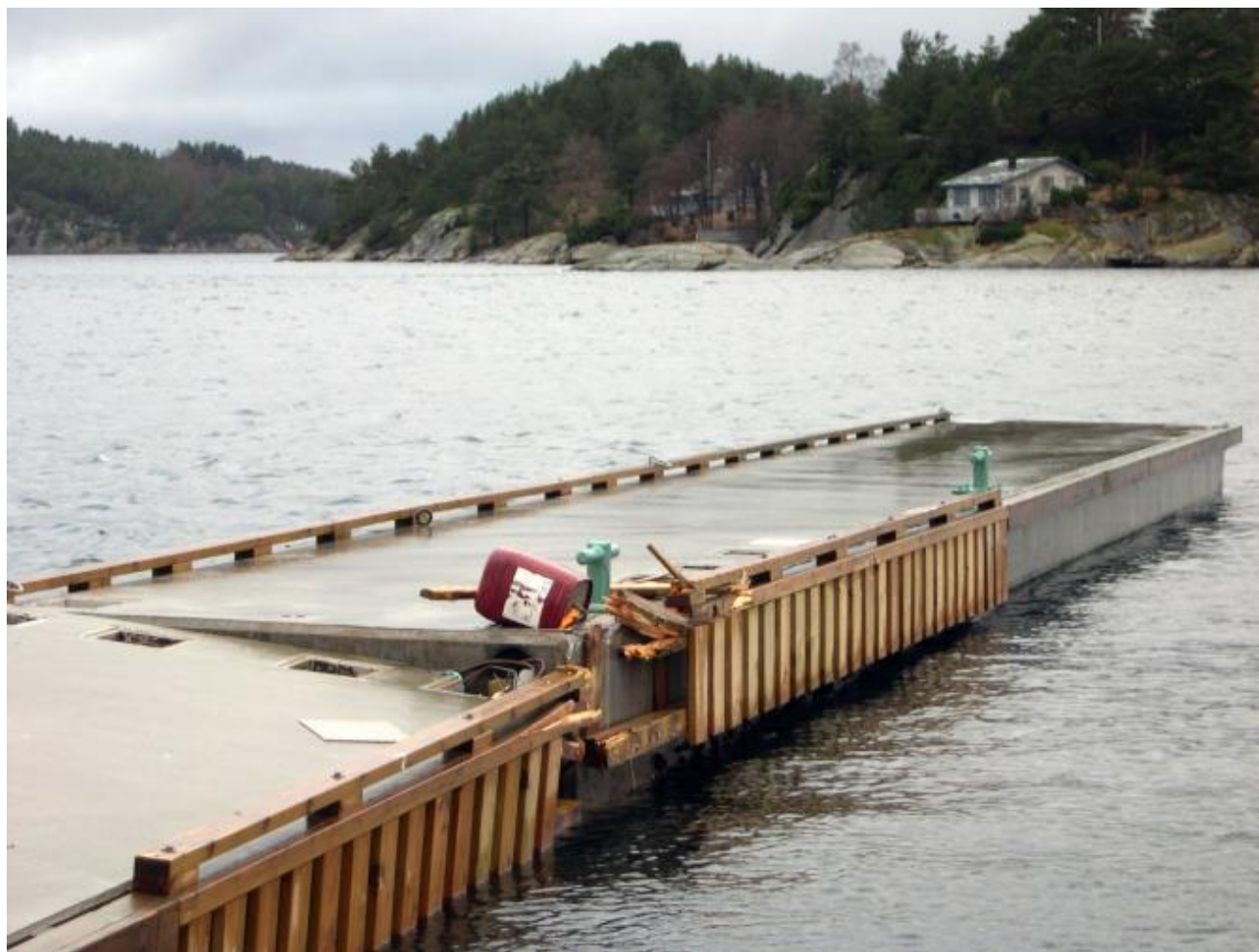
Ikkje minst betong-konstruksjonane i enden av piren fekk merka orkanen. (Foto: Ola Matti Mathisen)
