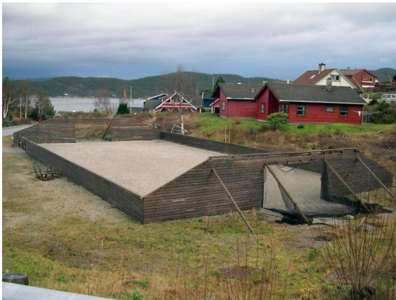
Ballbingen i Korsnes vil stå ferdig til våren (Foto: Ola Matti Mathisen)
