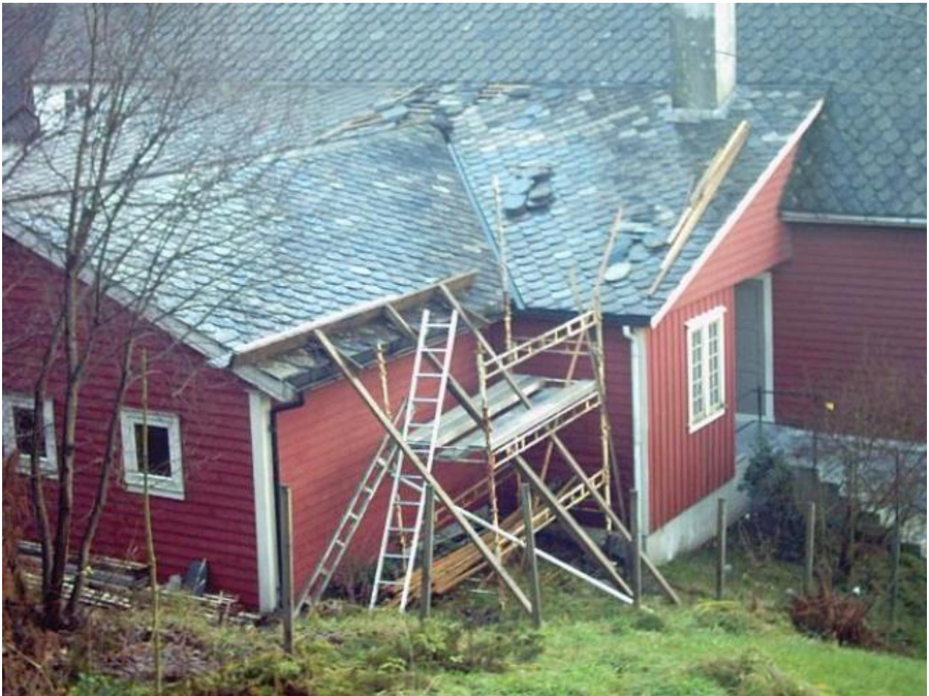
Det er ikkje ratt få dugnadstimar ein har brukt for å tetta taket på Helgheim. (Foto: Thor Inge Døssland)
