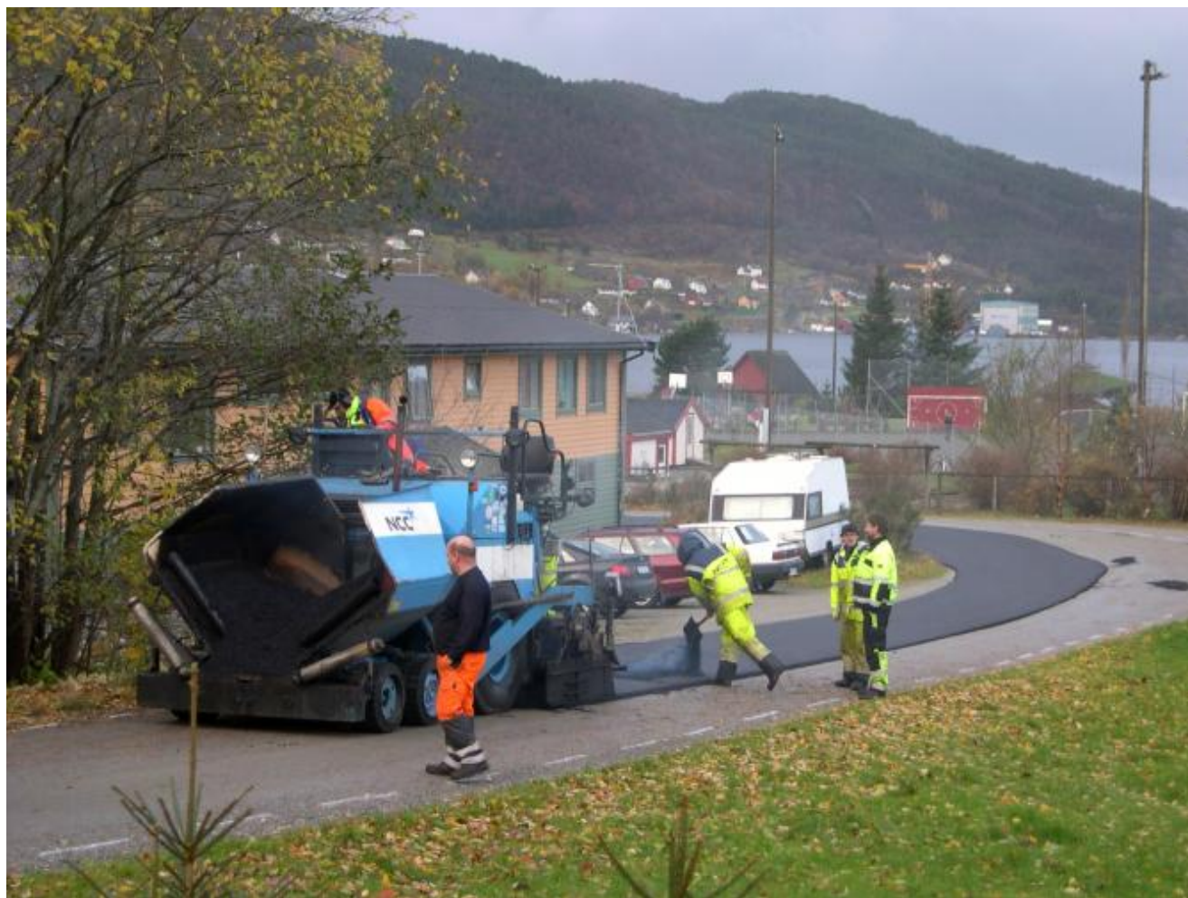
Gleda var stor i Uskedalen då NCC heldt fram med asfalteringa tysdag. Her er mannskap og maskinar i arbeid utanfor det tidlegare hagesenteret. (Foto: Ola Matti Mathisen)
