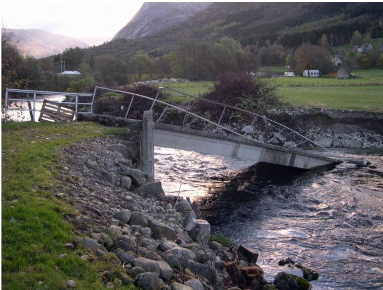
Magne Huglen har enno ikkje bestemt seg for om han skal nytta det gamle brudekket etter støypa heilt ny bru ved Dønhaughølen. Slik har den havarerte brua lege sidan flommen (Foto: Ola Matti Mathisen).
